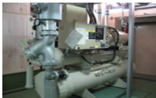
ヒートポンプ方式の冷暖房設備
