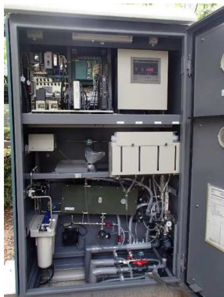
水質モニター内部
