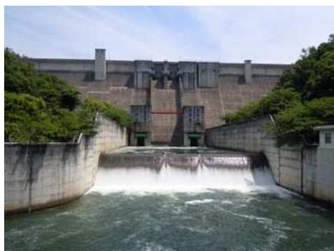
一庫ダム放流設備
