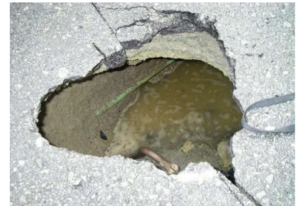
下水道管の老朽化による道路陥没
