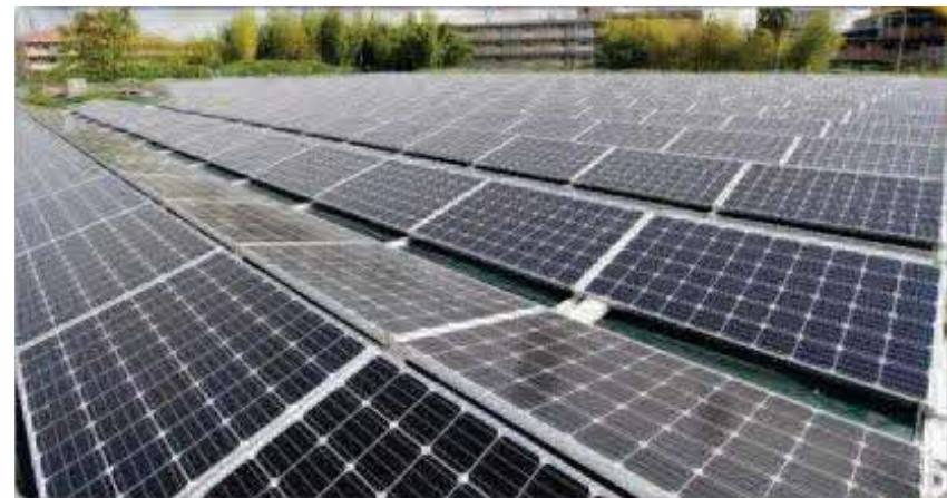
太陽光発電のソーラーパネル（新田配水場）
