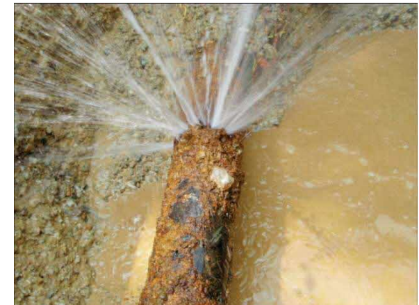
水道管からの漏水
