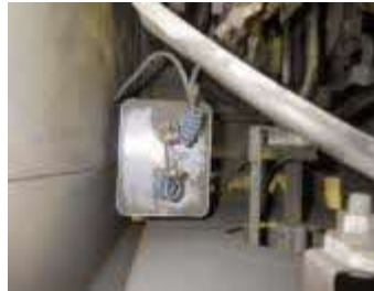
電気溶接機の内部に取り付けられた低圧コンデンサー
