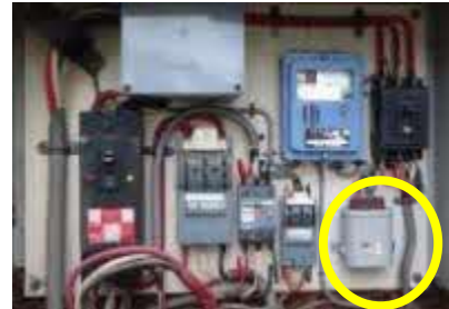
低圧分電盤内の低圧コンデンサー
