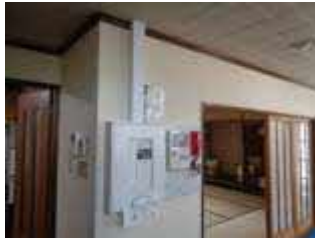
[写真 3-85] 自動火災報知設備 (主屋)
