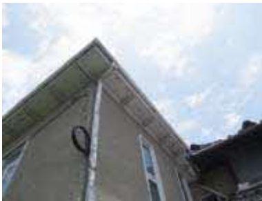
[写真 4-27]屋根 上屋根樋毀損、樋塗装全体的に毀損
