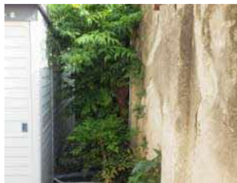
[写真 4-14] 実生木の南西部煉瓦塀への圧迫（南西庭）
