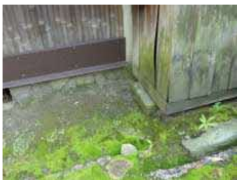
[写真 4-7]主屋東石の欠損・移動（北東庭）
