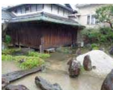
[写真 4-6] 豪雨時の排水不良 〔南庭(青龍庭)〕 令和2年(2020年)7月14日
