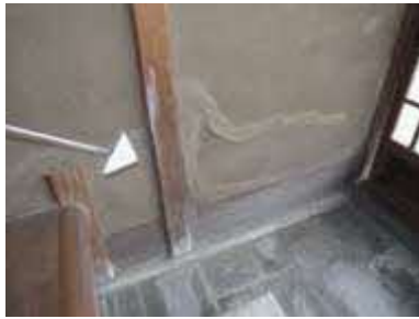
[写真 4-28] 玄関 左官壁一部毀損
