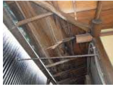
[写真 4-31] 垂木 白アリ被害
