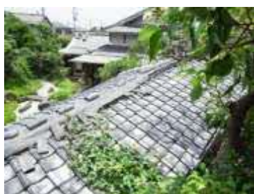
[写真 4-25] 棟瓦、平瓦、軒瓦のずれ、葛等の繁茂が屋根土に到達
