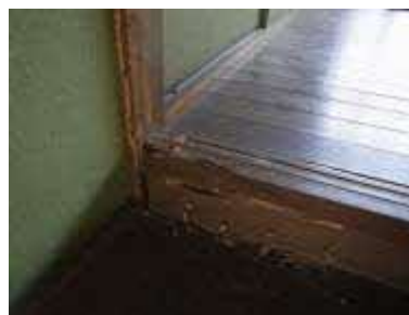
[写真 4-35]本玄関 蟻害
