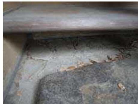
[写真 4-33] 土間三和土割れ
