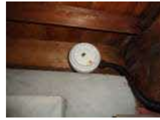
[写真 3-87] 自動火災報知設備無線アンテナ (洋館地下)
