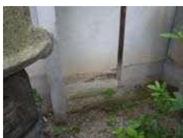
[写真 4-21] 北高塀 壁剥落
