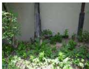
[写真 4-26] 控え柱腐朽
