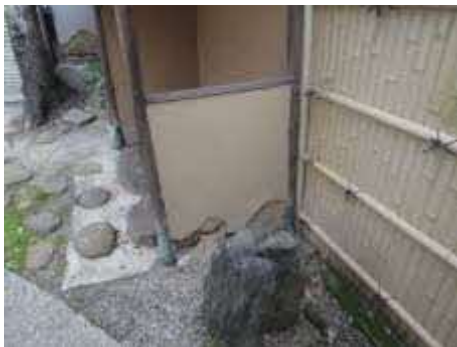
[写真 4-32] 左官袖壁腐朽
