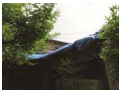
[写真 4-34]内玄関 縁側上部庇の傷み
