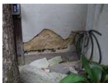
[写真 4-22] 東高塀 小壁左官亀裂
