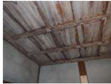
[写真 4-29] 女中部屋 天井雨漏り跡
