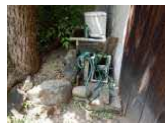
[写真 3-84] 給排水施設
