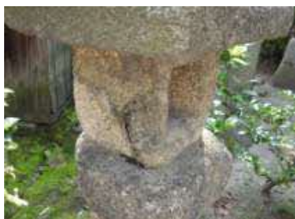
[写真 4-15] 石燈籠2 火袋の割れ（北東庭）
