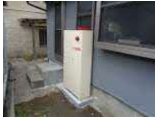
[写真 3-86] パッケージ型 消火設備 (離れ西側)
