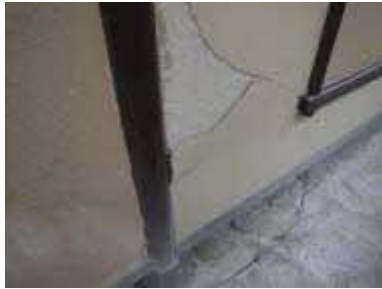
[写真 4-30] 壁面 土壁毀損
