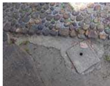
[写真 4-3] 表土の流出・補修(中庭)
