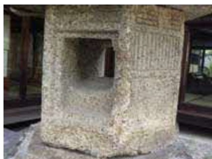
[写真 4-16] 石燈籠8 火袋の割れ（中庭）
