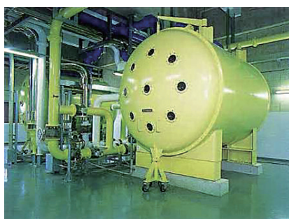
オゾン発生器（大阪広域水道企業団※）
