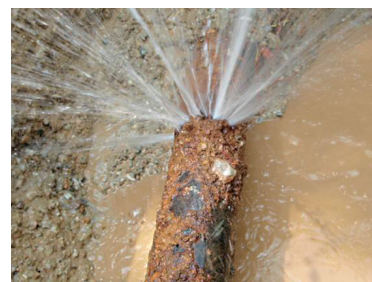
水道管からの漏水
