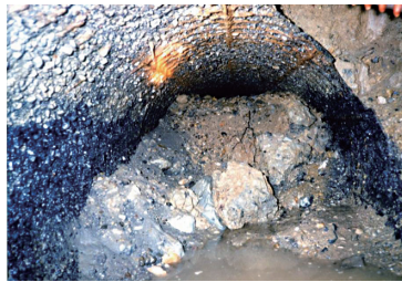
硫化水素※による下水道管の腐食
