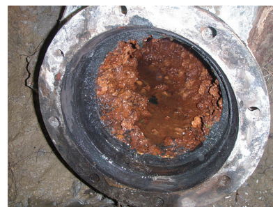
古くなった水道管の内部
