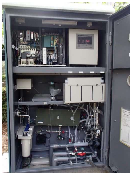
水質モニター内部
