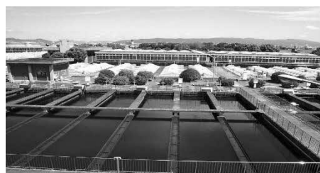
原田処理場 水処理施設
