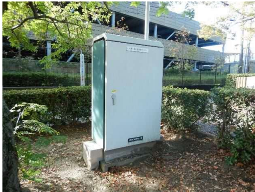
千里西町公園水質モニター (柿ノ木配水場系管末)
