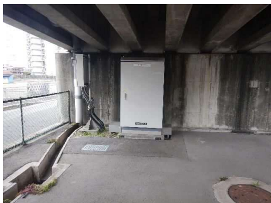
若竹水質モニター (新田配水場系管末)
