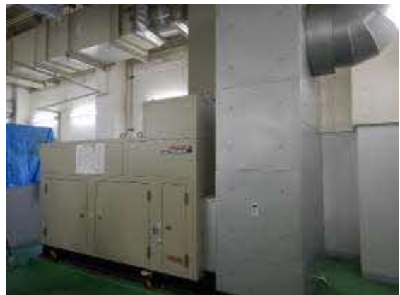
写真：非常用発電設備（柴原浄水場）
