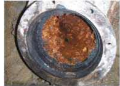
写真：古くなった水道管
