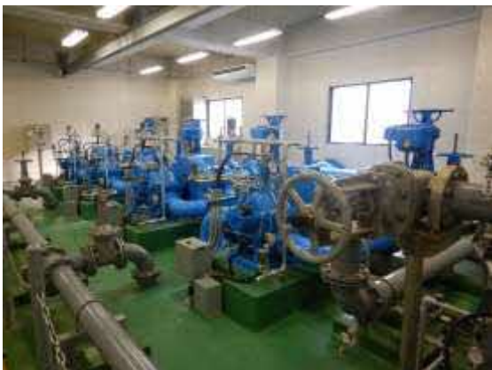
写真：ポンプ設備（柿ノ木受配水場）
