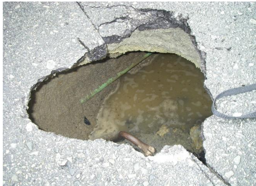
下水道管の老朽化による道路陥没
