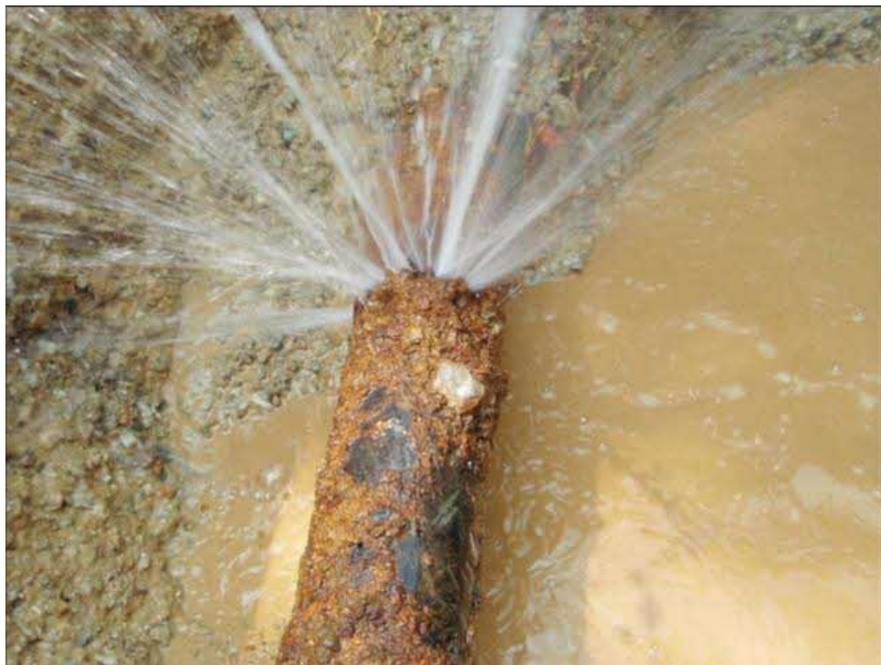
水道管からの漏水
