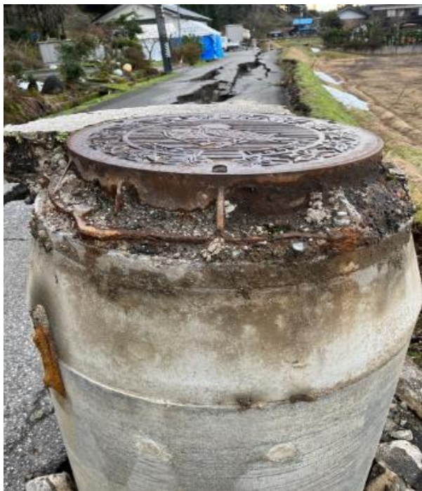
▲液状化で浮き上がったマンホール
