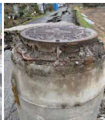
地震で隆起したマンホール
