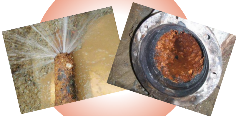
老朽化した水道管と漏水
