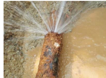
水道管からの漏水
