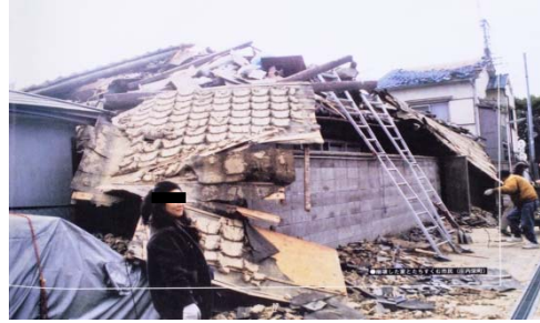
平成 7 年（1995 年）1 月 17 日に発生した阪神淡路大震災で被害を受けた家屋（庄内栄町）
