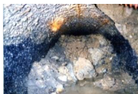
硫化水素※による下水道管の腐食
