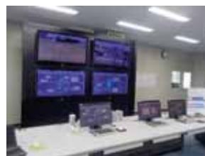
監視制御システムによる 集中監視（柴原浄水場）
