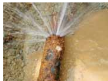
水道管からの漏水
