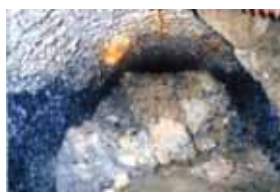
硫化水素※による下水道管の腐食
