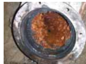
古くなった水道管の内部
