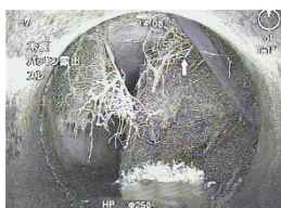
下水道管に入った木の根
