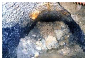
硫化水素※による下水道管の腐食
