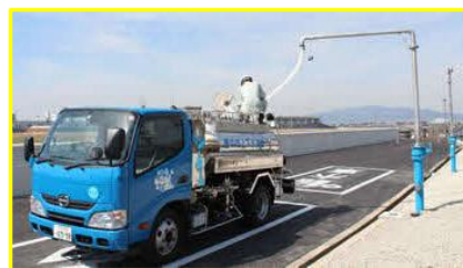
給水タンク車用給水設備
