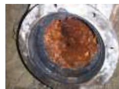
古くなった水道管の内部
