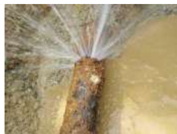
水道管からの漏水
