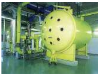
オゾン発生器(大阪広域水道企業団※)
