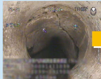
下水道管にひび割れ発見！
