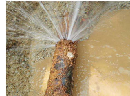
水道管からの漏水
