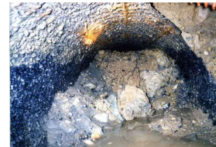
下水道管の腐食
