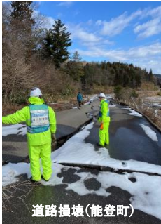
道路崩落(能登町)
