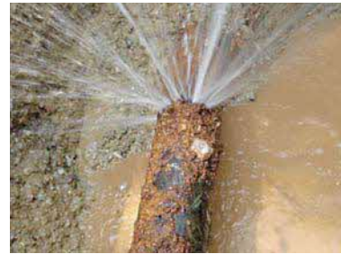
水道管からの漏水
