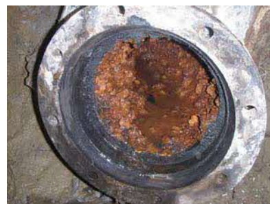
古くなった水道管の内部
