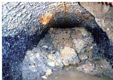
硫化水素※による下水道管の腐食
