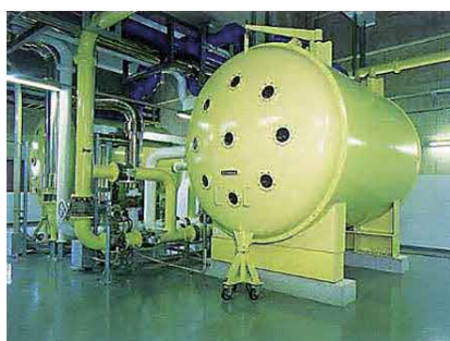
オゾン発生器（大阪広域水道企業団※）
