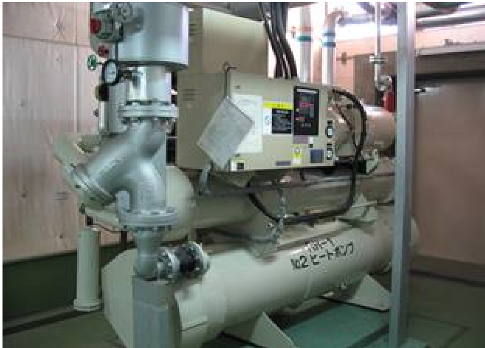
ヒートポンプ方式の冷暖房設備
