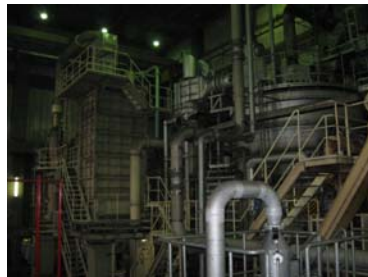
老朽化が進んでいる庄内下水処理場の汚泥焼却炉
