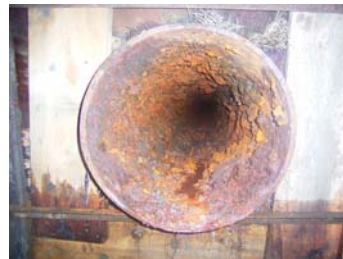
古くなった水道管の内部
