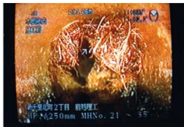
下水道管に入った木の根
