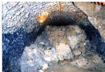
硫化水素※による下水道管の腐食
