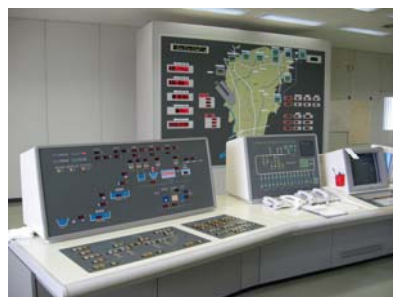
更新時期を迎えている監視制御システム
