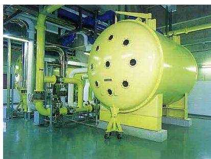
オゾン発生器(大阪府営水道)
