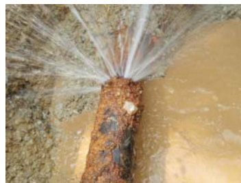
水道管からの漏水
