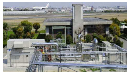
ガスエンジン発電機
