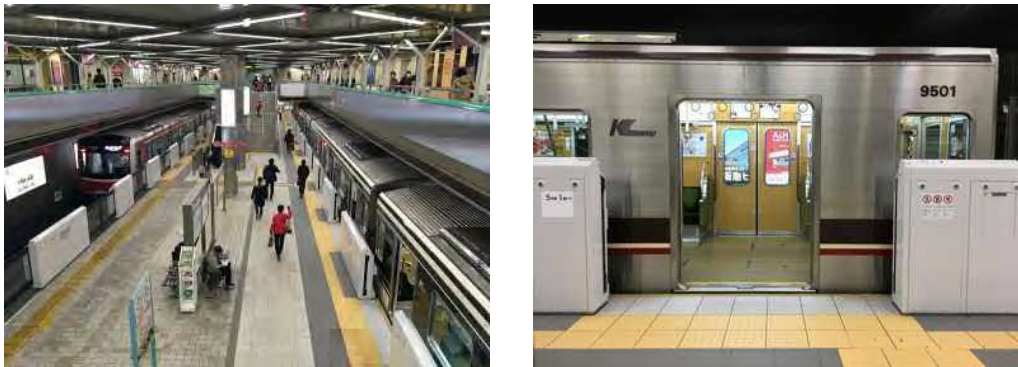
図 3.7 可動式ホーム柵設置状況（北大阪急行電鉄千里中央駅）
