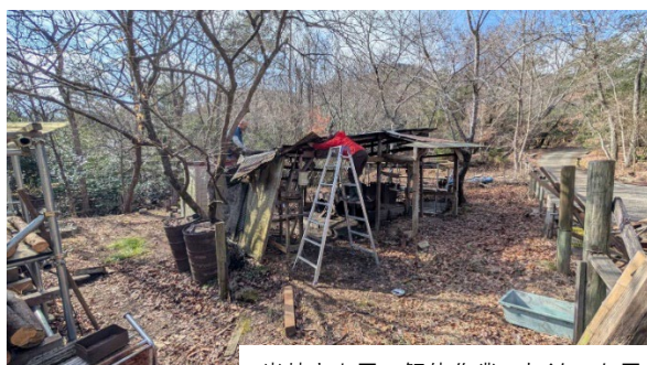
炭焼き小屋の解体作業。古くなった屋根や柱を撤去し、窯を掘り出した。
