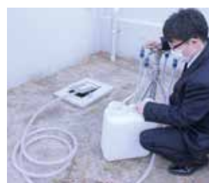
地下式の非常用給水栓
