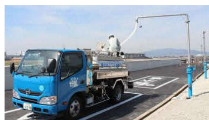
給水タンク車用給水設備
