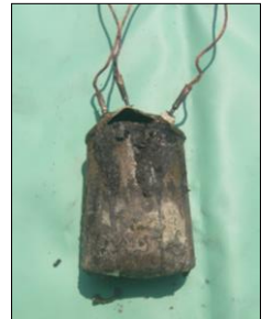
容器が破裂した低圧進相コンデンサ
