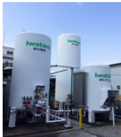
高圧ガス施設
