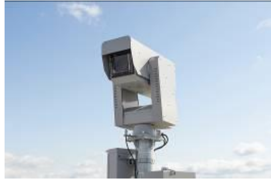
消防用高所監視施設
