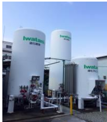
高圧ガス施設
