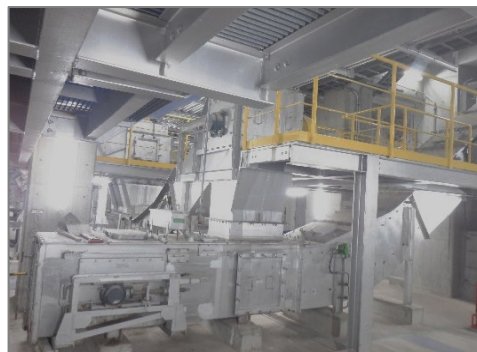
コンベヤの外観写真（2）
