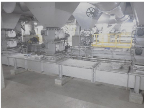
コンベヤの外観写真（1）
