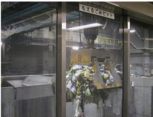
図 4-4 見学窓から見るクレーン動作状況
