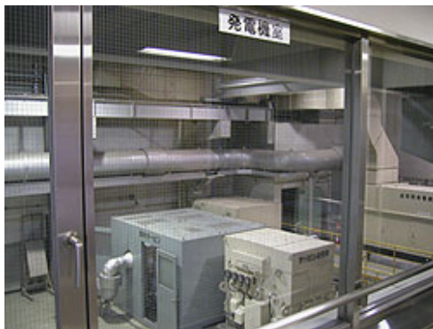
図 4-8 タービン発電機を見下ろせる事例 【写真 : 尾張東部衛生組合 晴丘センター】 http://www.haruoaka-center.com より引用
