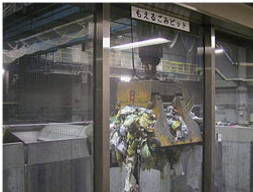
図 4-4 見学窓から見るクレーン動作状況
