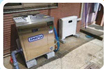
消滅型生ごみ処理機と蓄電池
