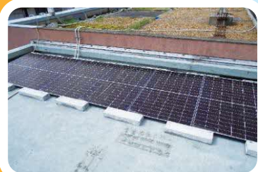
屋上に設置された太陽光パネル
