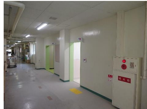
段差、扉のない1階トイレ出入口
