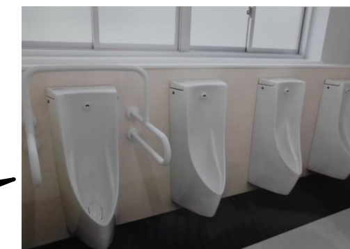
2階男子トイレ小便器
