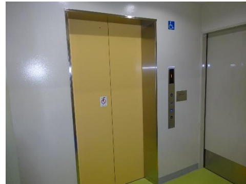
1階エレベーター
