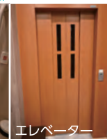
エレベーター
