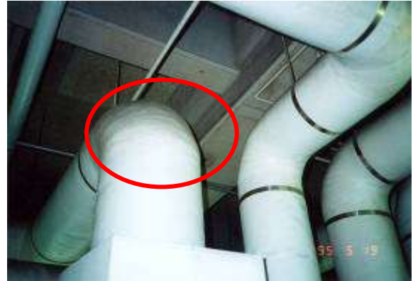
保温材（配管等）
