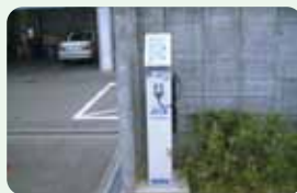
事業者による 急速充電ステーションの設置
