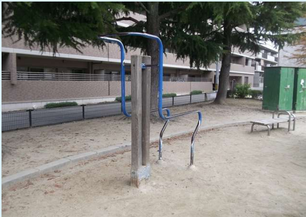
木製部材の劣化
