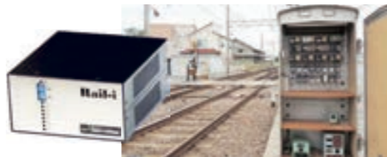
路切そばに設置されたボックスのなかに同社の監視・計測システムが格納されています
