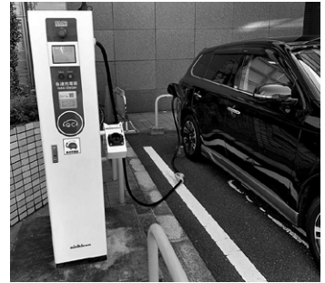
電気自動車の充電施設(市役所第二庁舎)
