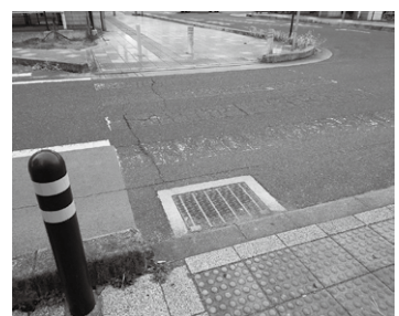
消えかかっている横断歩道の路面標示 (岡町駅付近)
