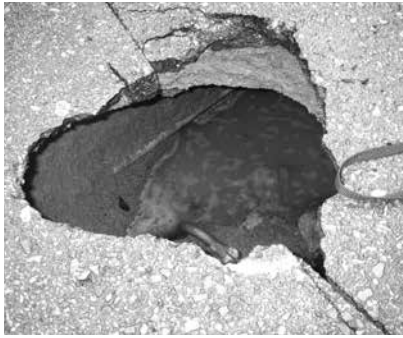
市内で過去に発生した、下水道管の老朽化が原因と考えられる道路陥没
