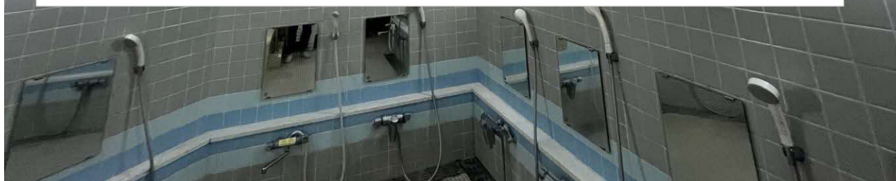
お風呂の天井に黒いシミが固着している
