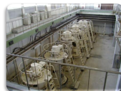
③ ポンプ場
