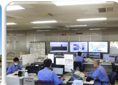
⑤ 中央監視室
