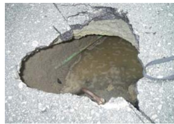
管路施設の老朽化が原因と考えられる道路の陥没
