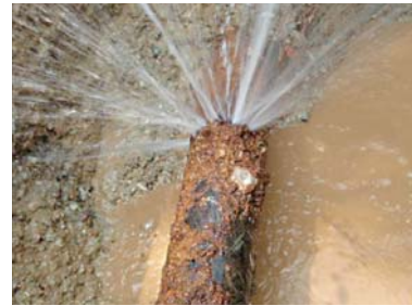
水道管からの漏水
