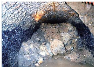
硫化水素※による下水道管の腐食
