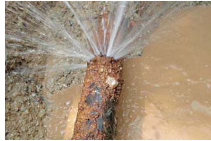
水道管からの漏水
