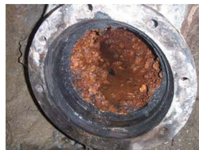
古くなった水道管の内部
