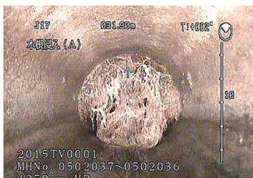
下水道管に入った木の根
