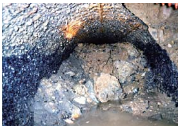
硫化水素※による下水道管の腐食
